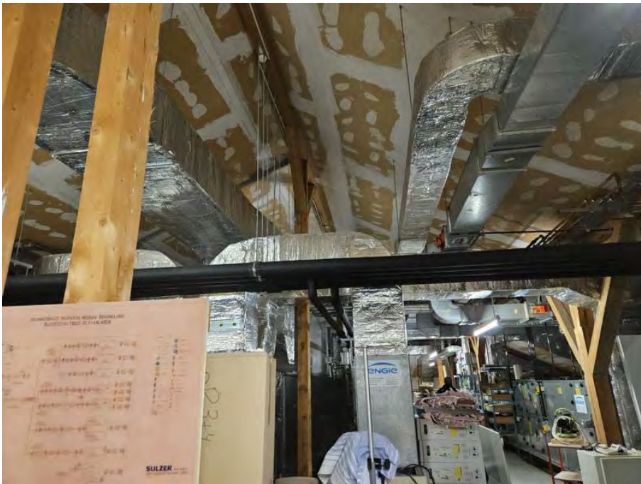
Abb. 15: Haus- und Lüftungstechnik im Dachstuhl über dem Westflügel
