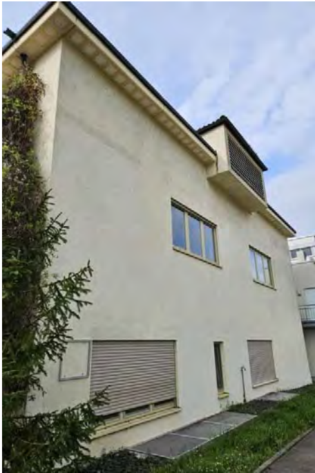
Abb. 18: An den Fassaden und Dachüberständen sind keine Spalten, Hohlräume und Fugen vorhanden, die eine Eignung für Vogel- und Fledermausarten besitzen.
